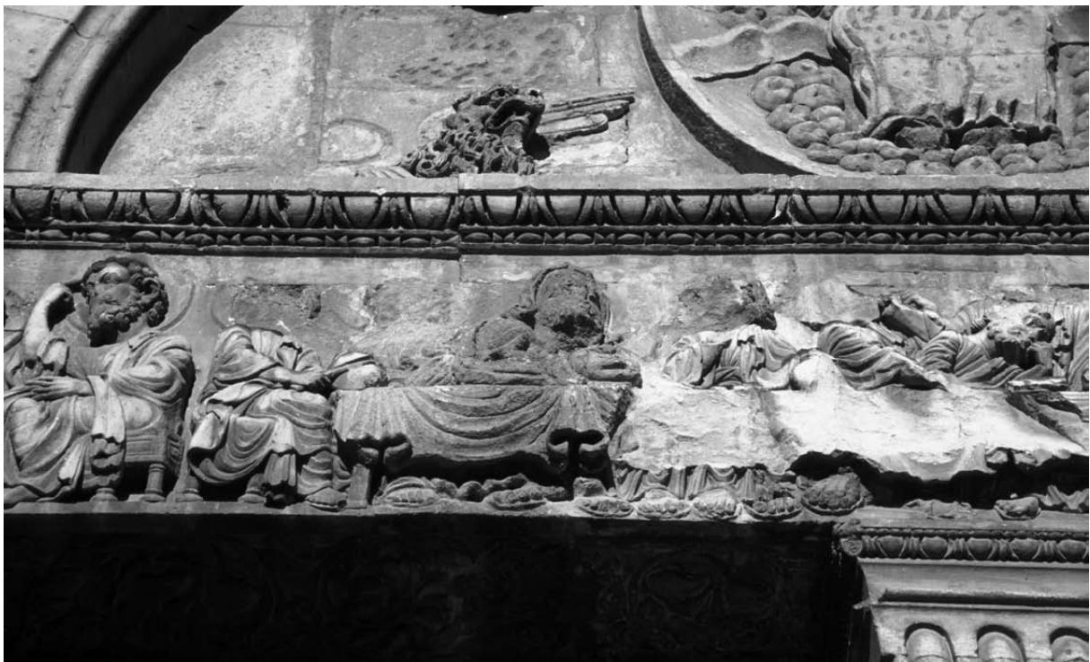
Abb. 75 Schadstellen im Türsturz des Hauptportals Reparaturen des 17. Jh. (Photos H. Hansen)
