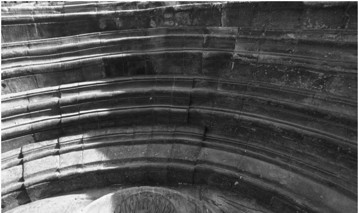
Abb. 81 Störungen in den Hauptportalarchivolten: Wellenförmige Übergänge und Absackung von Segmenten 250
