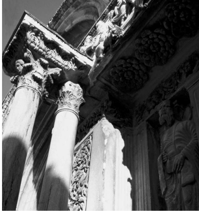
Abb. 106 Kämpferplatte der südlichen Doppelsäulenkonstruktion bindet nicht über die gesamte Breite ein
