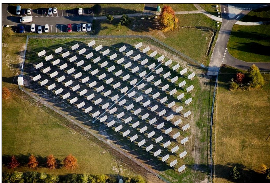
Photo 11 – La CPVS de Martillac (Gironde), implantée dans la Technopole Bordeaux Montesquieu, met en œuvre la technologie de suivi de la course du soleil (trackers solaires) de l'entreprise girondine EXOSUN
