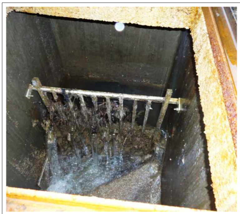
Figure 19 : « Au milieu d'une végétation importante, voire luxuriante, on trouve un dégrilleur plein et non entretenu ». Source : Collectif de défense du Doubs et du Dessoubre, mars 2015
